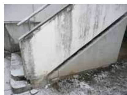
震災で壊れた非常階段
