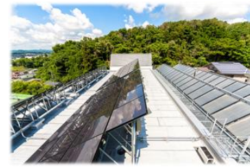
ソーラーパネルと集熱パネル
