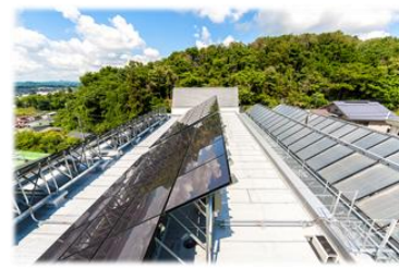
ソーラーパネルと集熱パネル
